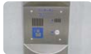
非常用インターホン
